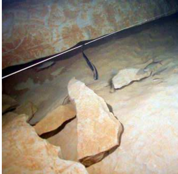
Elástico que ha saltado; un anclaje suprimido
